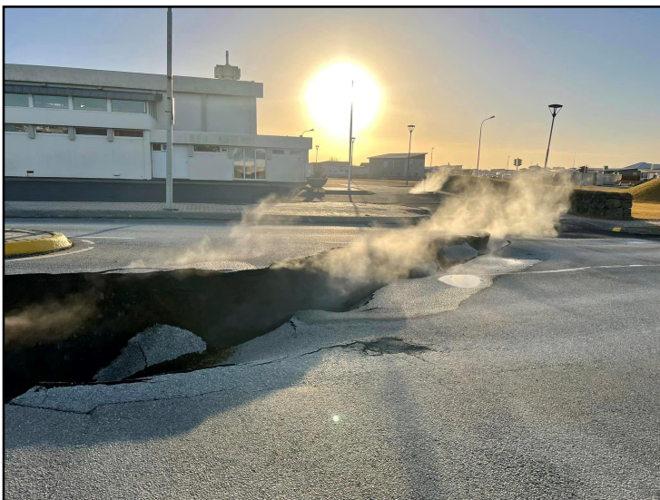
Um eins meters djúpur sigdalur myndaðist í gegnum Grindavík samfara jarðskjálftum og kvikuhlaupi þann 10. nóvember 2023. Miklar skemmdir urðu á innviðum og mannvirkjum yfir allt áhrifasvæðið. Ljósmynd: visir.is
